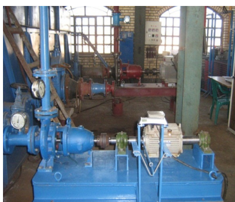
شکل ۷- مجموعه‌ی پمپ و موتور معلق شده
