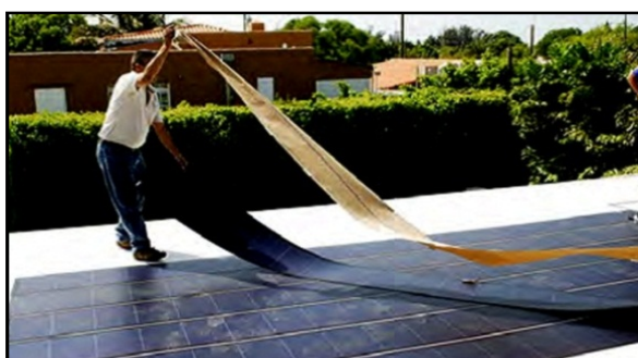
شکل ۱۰- آرایه خورشیدی لایه نازک و انعطاف‌پذیر سیلیکون آمورف در حال پهن شدن روی پشت بام
