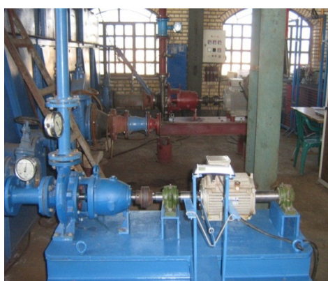
شکل ۷- مجموعه‌ی پمپ و موتور معلق شده
